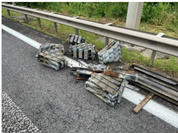
Anciennes pièces des joints de chaussée
