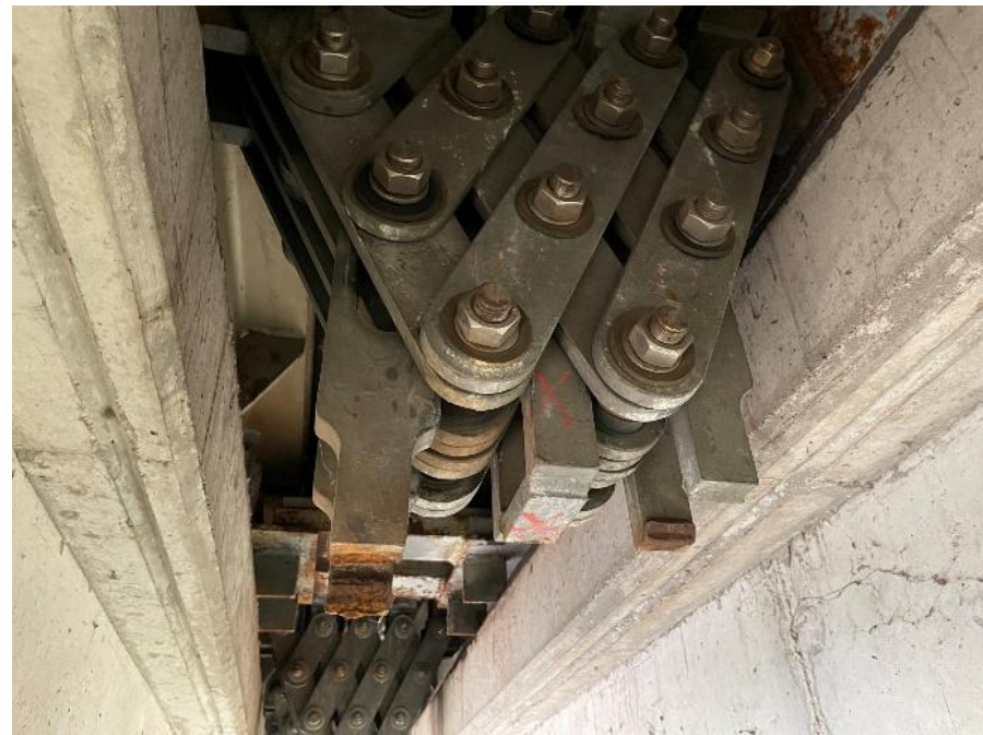
Ruptures au niveau des pantographes
