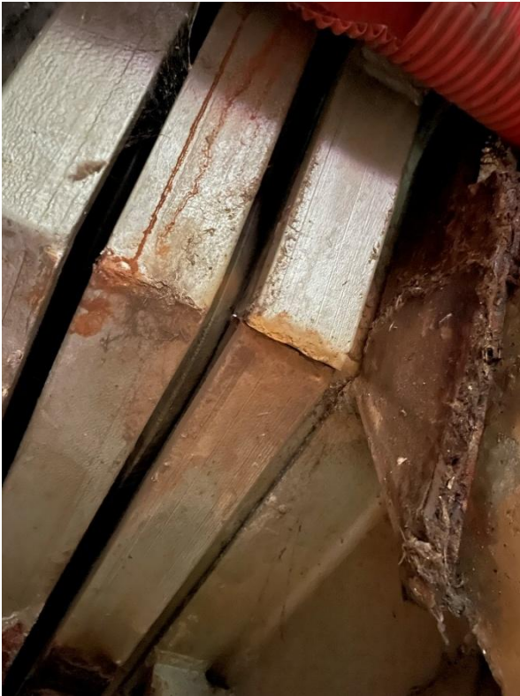
Rupture complète d'un profilé
